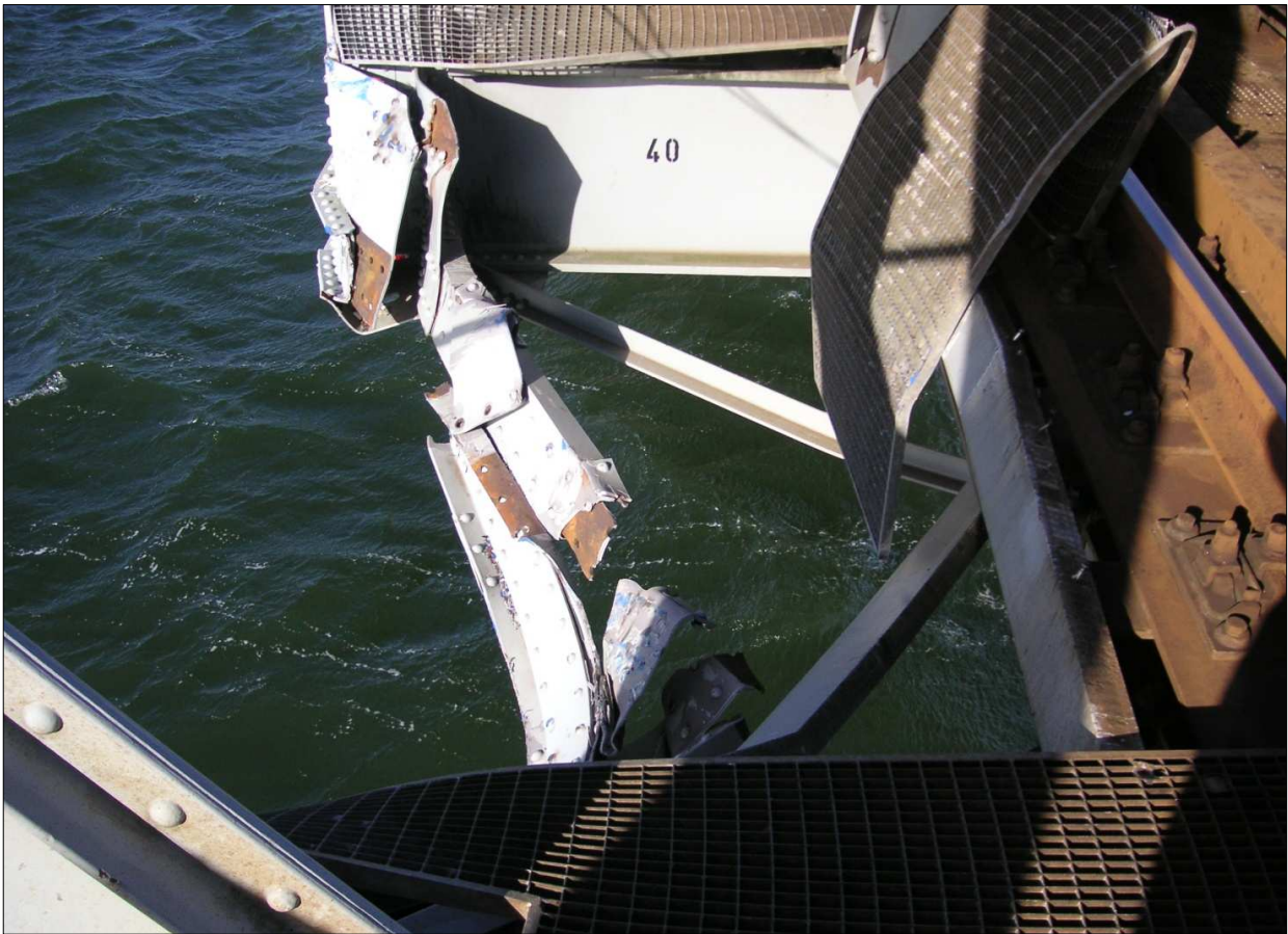
Figur 13: Kollisionsskader på Jernbanebroen Kilde: Den Maritime Havarikommission
