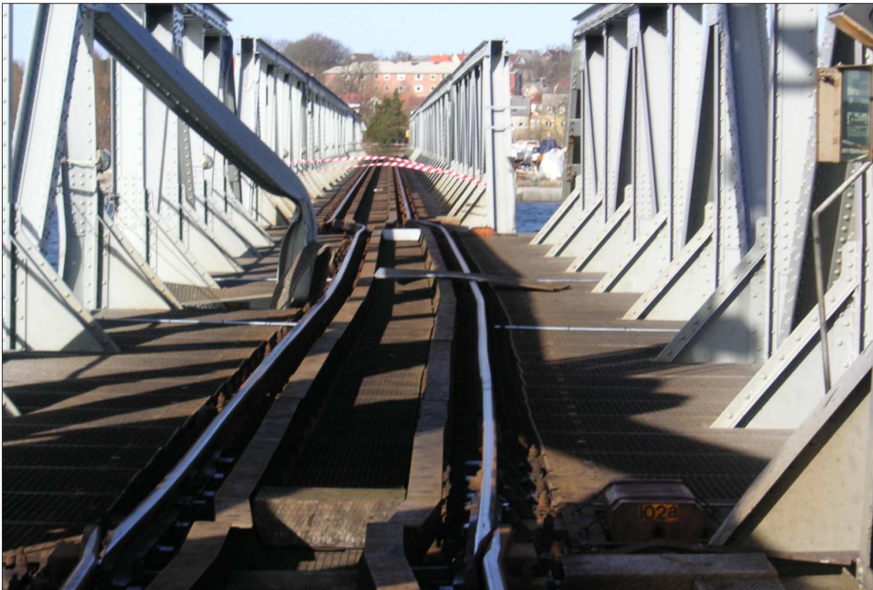
Figur 14: Kollisionsskader på Jernbanebroen Kilde: Den Maritime Havarikommission
