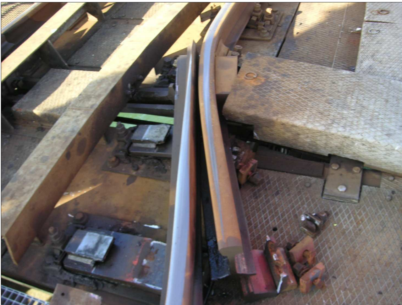
Figur 15: Kollisionsskader på Jernbanebroen Kilde: Den Maritime Havarikommission
